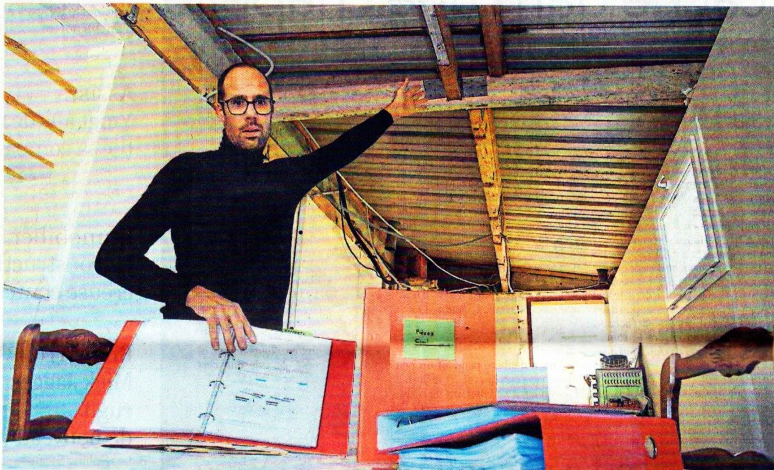
Denée, lundi. Sous la toiture en ardoise, de la tôle a été mise à jour. Selon le rapport d'expertise, elle risque de s'effondrer.
